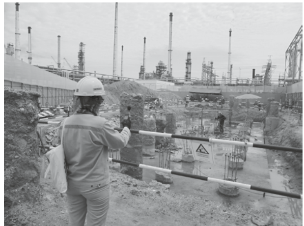
ภาพการตรวจวัดระดับเสียงภายในโครงการก่อสร้าง
